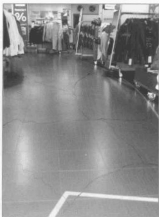
Unter Zuhilfenahme von Gegenlicht konnten so genannte Wurmfallen am PVC-Belag nachvollzogen werden. Im jeweiligen Rissbereich hatte sich der PVC-Belag gelöst.
