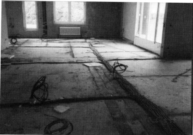
Bild 2: Wegen Rohrleitungen und dem fehlenden Halt für die sichere Verlegung von Dämmplatten ist eine Folie unzweckmäßig.
